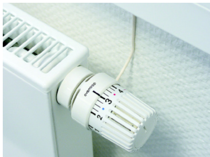
Abb. 2: Oventrop „Uni LHZ“ mit Netzwerkverkabelung über Kabelkanal.
